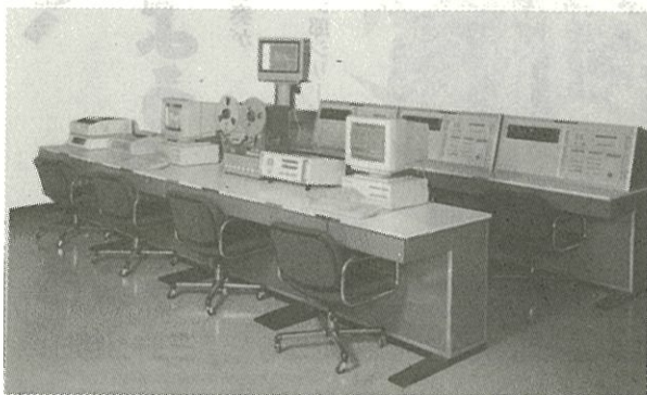
SENSAS/不法電波監視システム
