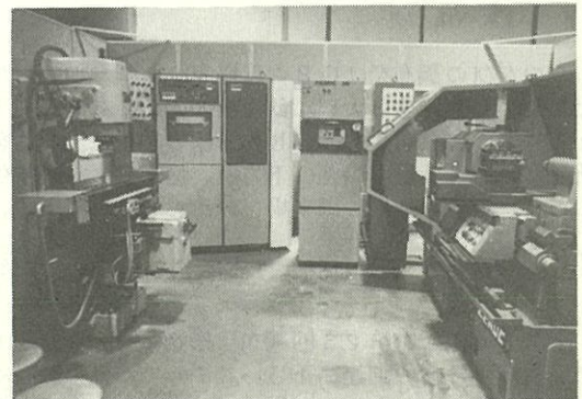
機械工場内部(N.C)
